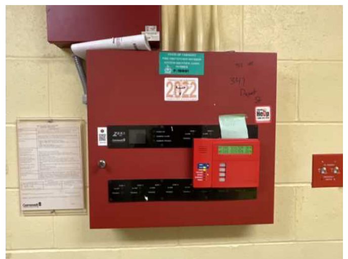
24 - FIRE ALARM ENUNCIATOR PANEL
