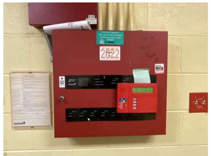
24 - FIRE ALARM ENUNCIATOR PANEL
